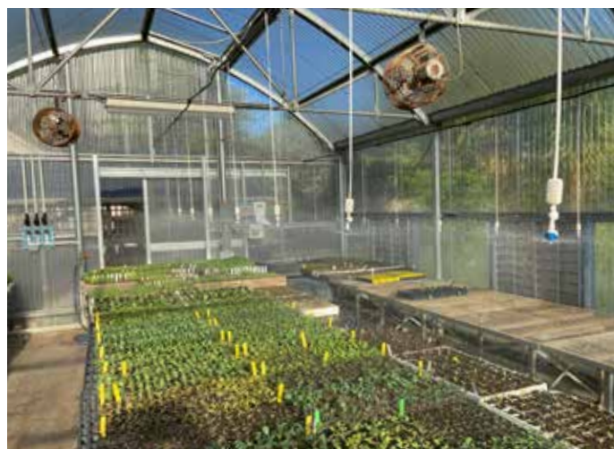
FIGURA 23. Válvulas solenoides típicas de 3/4" con filtros para evitar residuos de obstrucción en las boquillas de los rociadores. Diseño de tres secciones, tres válvulas, controlador en la parte posterior derecha de la foto, válvulas para cada sección en la parte posterior izquierda de la foto y rociadores dispuestos uniformemente sobre cada sección para proporcionar suministro uniforme de agua. Fotos: Christof Bernau
